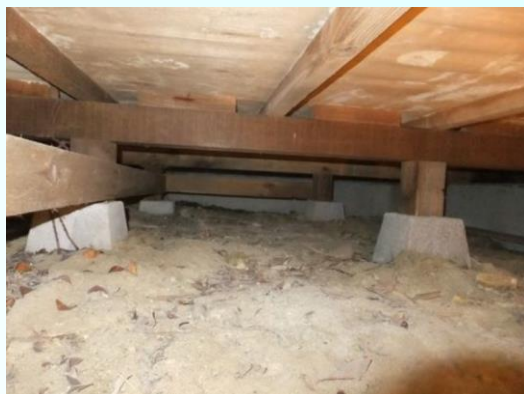
無断熱の床下
